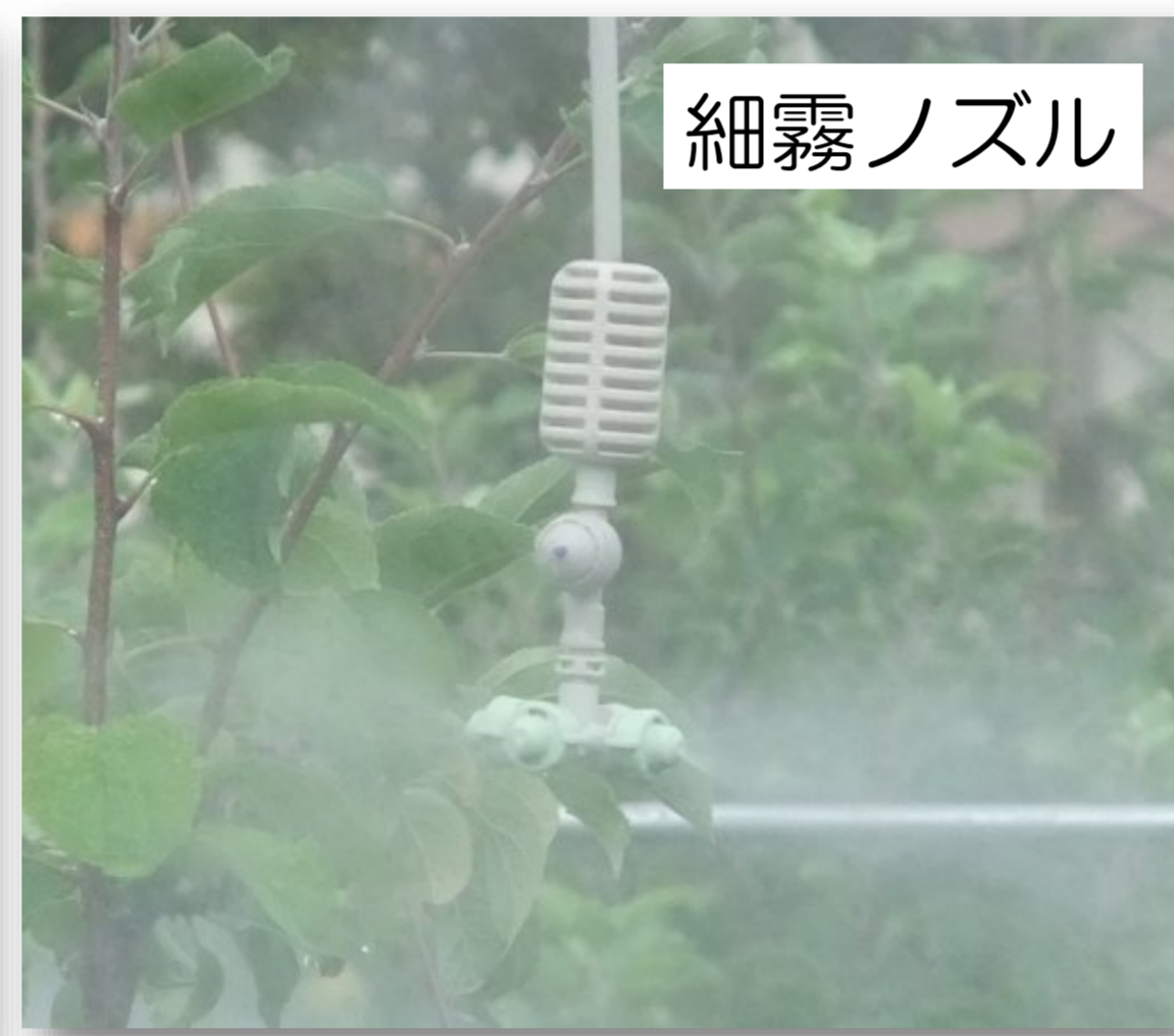
わい化栽培における細霧冷房装置の設置例 (既存支柱を利用した設置)
